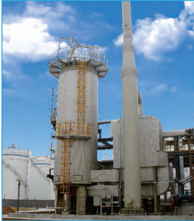
法国德西尼布宁夏哈纳斯1500万大卡/小时LNG加热炉项目 France Technip Ningxia Kanas 15 Mkal/h LNG heater station project.
