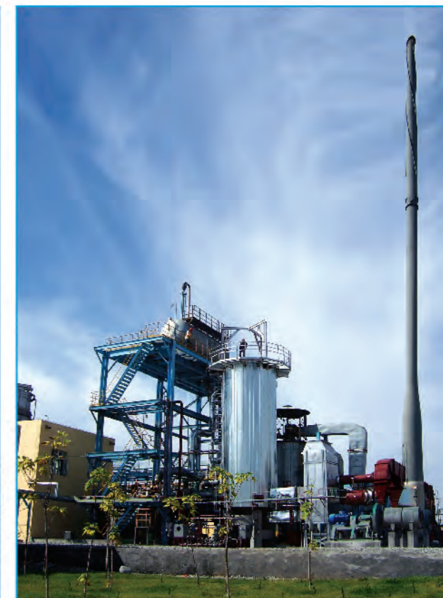
新疆天利高新甲乙酮装置900万大卡/小时导热油炉 9 Mkcal/h hot oil heater for MEK plant, Tianli Hi-tech Corp., Xinjiang
