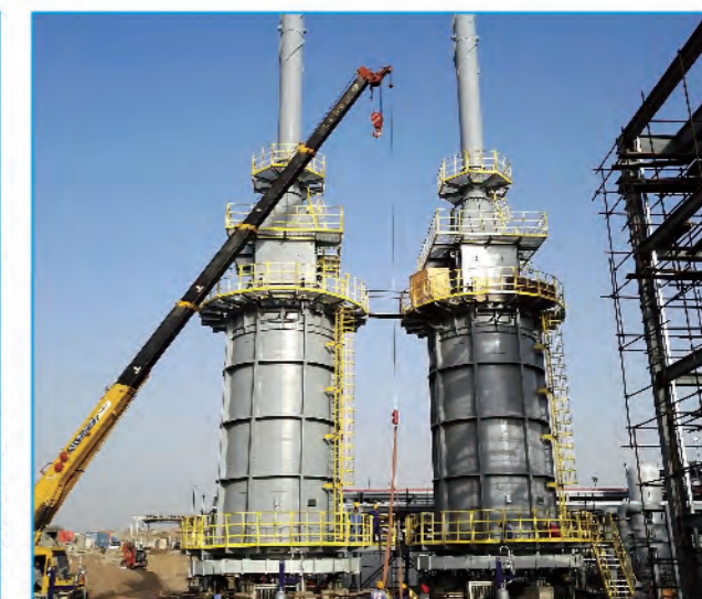
巴基斯坦HBP热媒站现场 Pakistan HBP hot oil heater station
