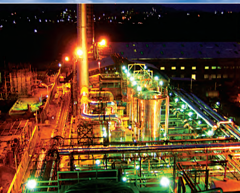
印度JBF热媒站现场 India JBF hot oil heater station
