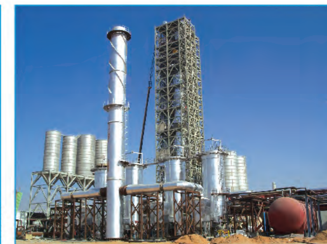
阿联酋30万吨聚酯工程 300,000 tons Polyester project in U.A.E
